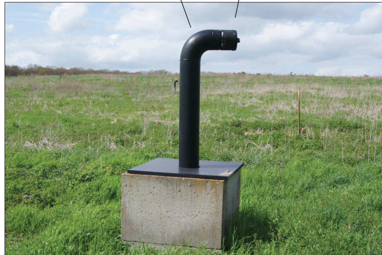
Illustration 1 : Puits de biogaz présents sur l'ancien CET de la ville de Vendôme
