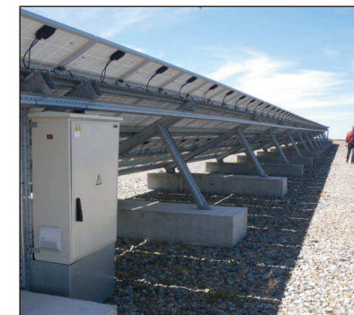
Photo 2 : Câblage intégré aux structures
