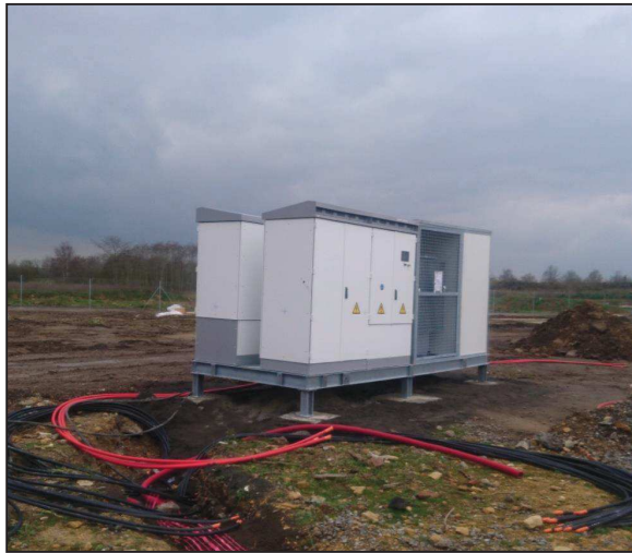
Photo 3 : Exemple de poste électrique « outdoor » (sans fondation)
