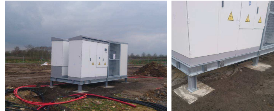
Illustration 2 : Photo d'un poste de transformation (onduleurs + transformateur) « outdoor » (Source : IEL)
